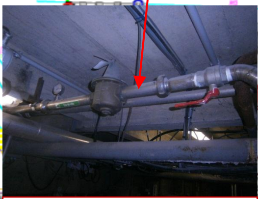
Vanne d'isolement eau de ville (alimentation cantine + vestiaire)
