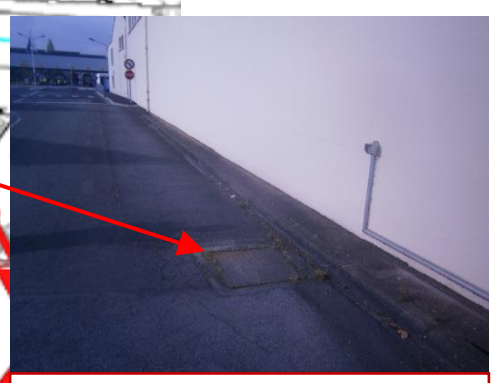
Vanne coupure générale eau de ville
