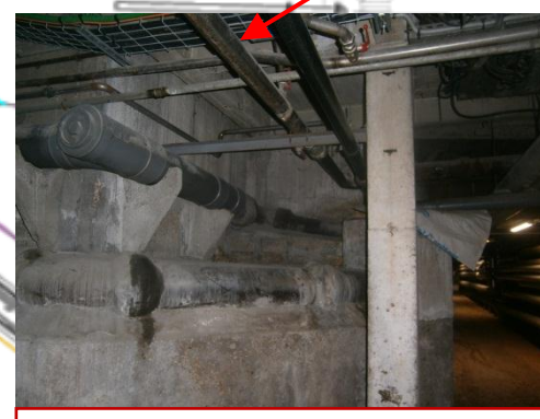
Vannes d'isolement eau de ville (alimentation laboratoire + générale)
